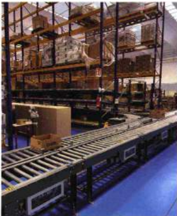
L'impianto di movimentazione e immagazzinamento automatici dei colli è stato supportato dalla tecnologia del sistema di cablaggio intelligente SmartWire-DT di Eaton, che ha ottimizzato l'automazione dei nastri trasportatori.
